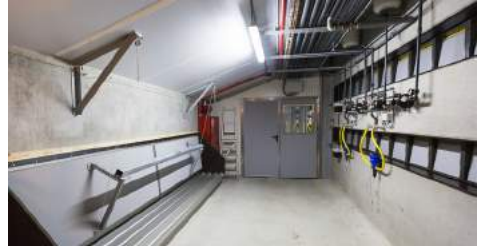
Ruimte tussen pad koeling en inlaatventielen naar de stal
