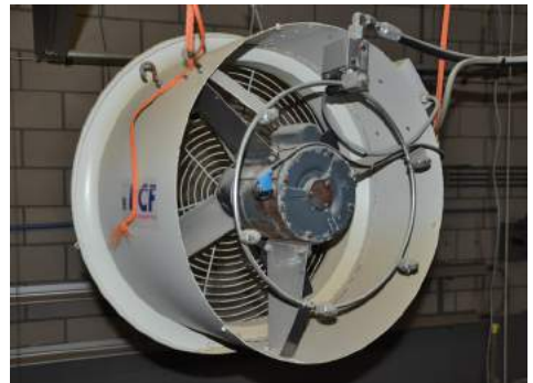
Nevelkoeling met recirculatieventilator
