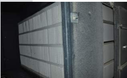
De verse lucht komt binnen door de lamellen, de warme lucht gaat langs de lamellen naar buiten
